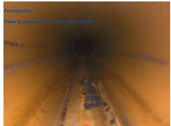
Abbildung 5: Allgemeiner Zustand SAW-Leitung
